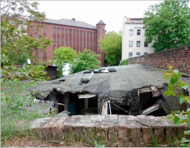
Blick auf die baufälligen Remisen des Grundstücks Karl-Marx-Straße 151 und die rückseitige Fassade des Umspannwerks.
